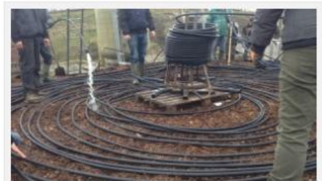
de slangen voor de warmte uitwisseling liggen bij deze biomeiler in spiraalvorm in plaats van het gebruikelijke 'uitgewaaierde kaartendek'
